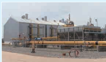
インドネシア・ガスパイプライン コンプレッサステーション
